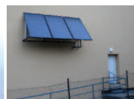
Solární panely slouží především k ohřevu vody
